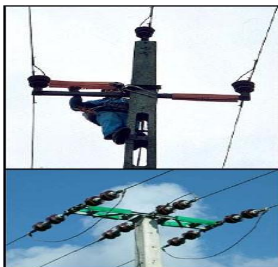
شکل 32: عایق نمودن روی کراس آرم فلزی جهت جلوگیری از بروز پرنده زدگی فاز - زمین
