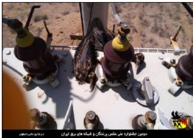
شکل 19: کاور نشدن اتصالات سر بوشینگ ترانسفورماتور هوایی و برق گرفتگی پرندگان
