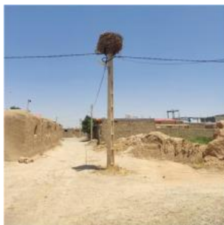
شکل 36: استفاده از کابل های خودنگهدار فشار ضعیف بهترین راهکار برای حفاظت لانه پرندگان
