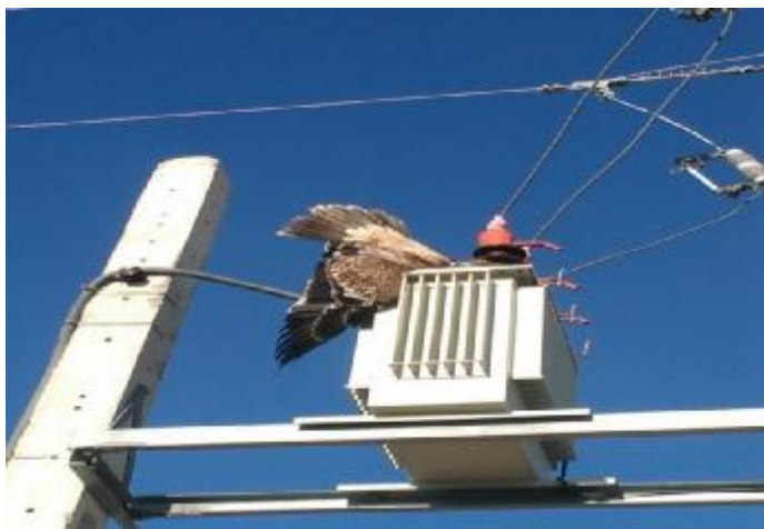
شکل 41: پرنده‌زدگی در پست هوایی
