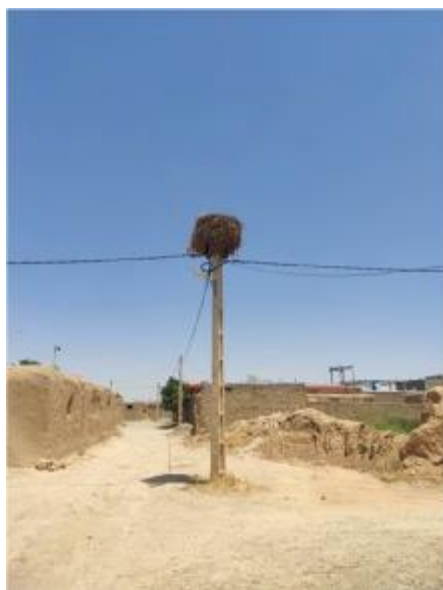
شکل 50: استفاده از کابل های خودنگهدار فشار ضعیف بهترین راهکار برای حفاظت لانه پرندگان
