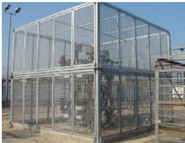
شکل 13: مسقف نمودن بانکهای خازنی
