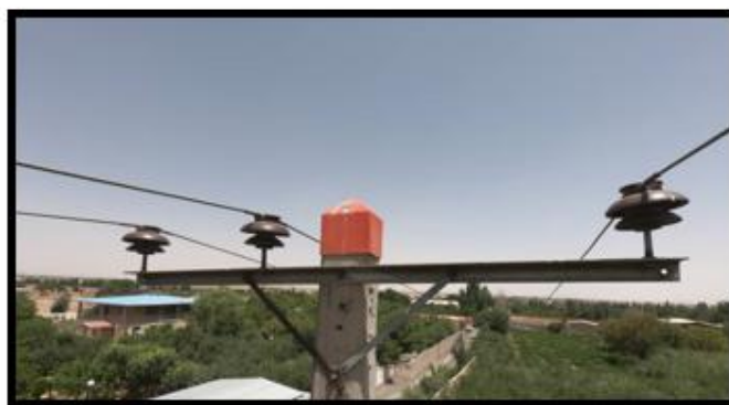
شکل 35: استفاده از کاور عایق راس تیر جهت کاهش خطرات برق گرفتگی پرندگان
