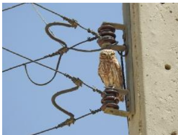
شکل 48: خطر برق گرفتگی در شبکه های فشار ضعیف لخت
