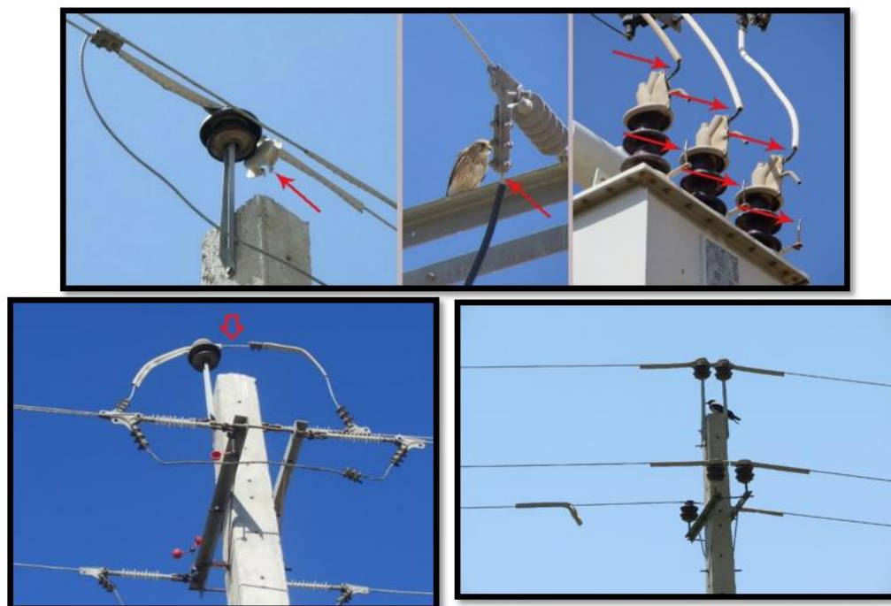
شکل 31: عایق کاری نامناسب و غیر استاندارد مقره در شبکه فشار متوسط
