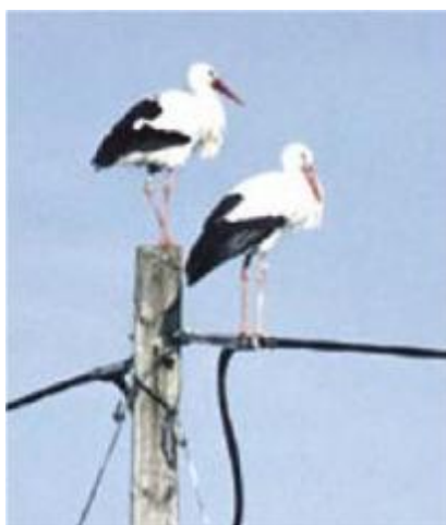
شکل 49: استفاده از شبکه عایق (کابل خودنگهدار) برای جلوگیری از پرنده زدگی در خطوط فشار ضعیف
